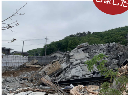
取り壊された旧市民活動センター
