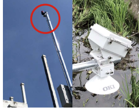
整備された朝倉樋管の赤灯と姥川の水位計
